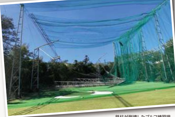
鉄柱が倒壊したゴルフ練習場 写真提供=千代が丘ゴルフクラブ
