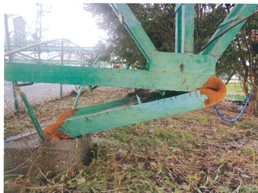
写真 3.6 鉄柱を構成するH形鋼の変形(2)
