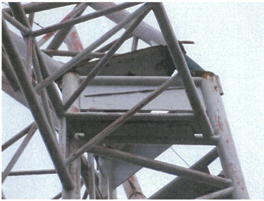
写真 3.34 被害部分の拡大写真(1) (北側の鉄柱)
