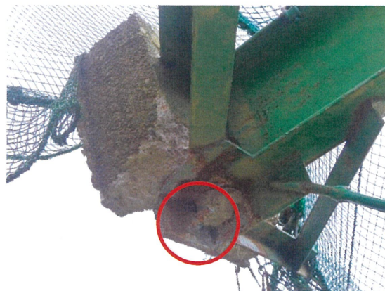
写真 3.3 柱脚アンカーボルトの破断(1)
