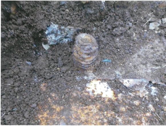
写真 3.22 破断したアンカーボルト
