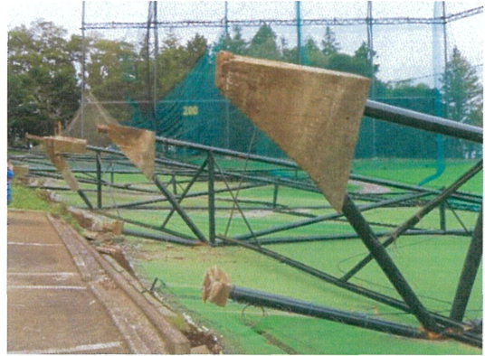
写真 3.23 引き抜けた柱脚(1)
