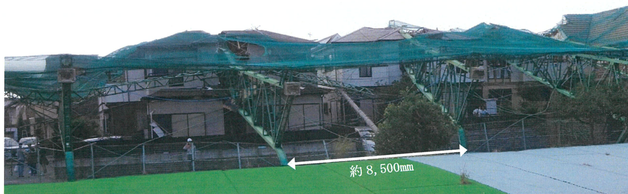
写真 3.1 鉄柱の倒壊状況
