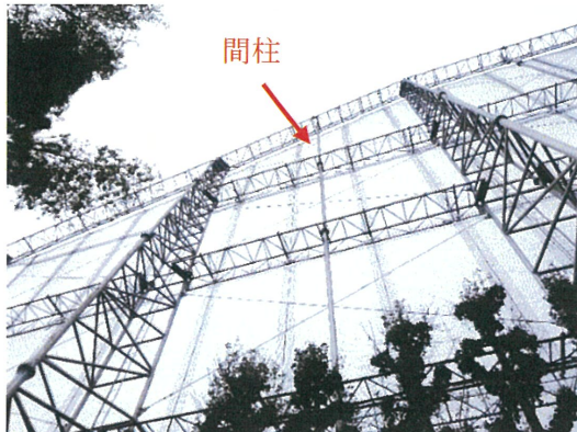
写真 3.28 無被害の鉄柱と間柱
