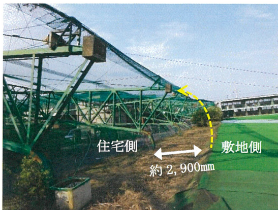
写真 3.2 鉄柱の倒壊状況
