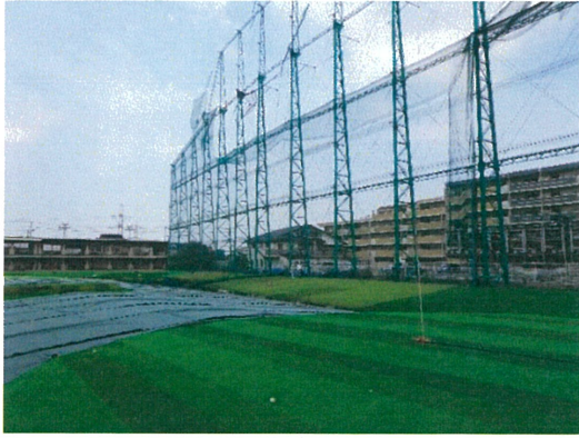
写真 3.10 敷地をはさんで倒壊した鉄柱の反対側にある鉄柱の状況
