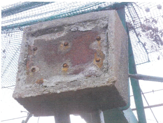
写真 3.4 柱脚アンカーボルトの破断(2)
