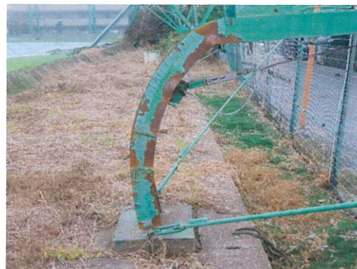
写真 3.7 鉄柱を構成するH形鋼の変形(3)
