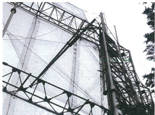
写真 3.31 折損した鉄柱(1)(南側の鉄柱)
