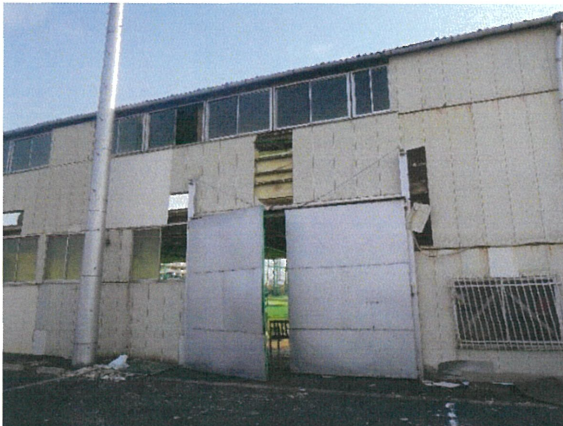
写真 3.14 ゴルフ練習場 A の建築物の外壁等被害
