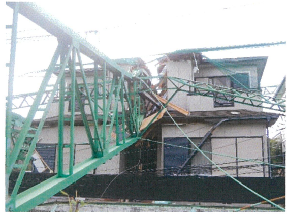
写真 3.11 近隣の住宅の被害(1)
