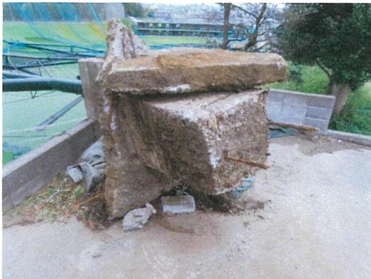
写真 3.24 引き抜けた柱脚(2)
