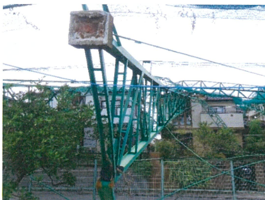
写真 3.8 隣接する住宅への倒壊状況
