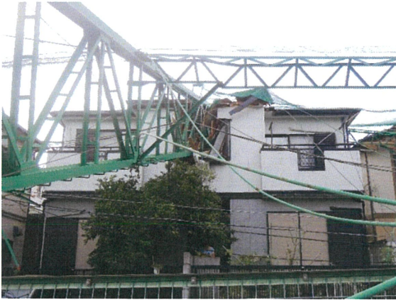
写真 3.12 近隣の住宅の被害(2)
