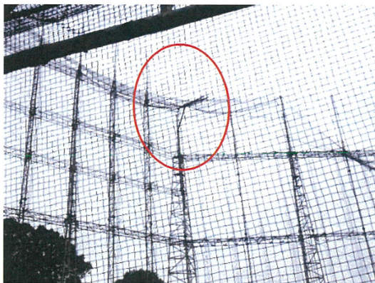
写真 3.30 先端部の被害状況(2)(南側)
