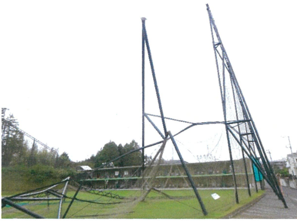
写真 3.16 鉄柱の倒壊状況(2)
