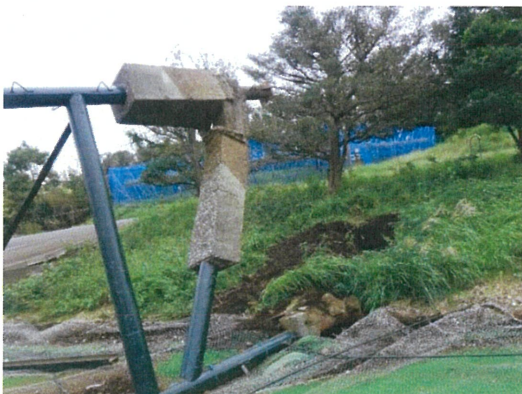
写真 3.26 写真 3.25 の引き抜け部分
