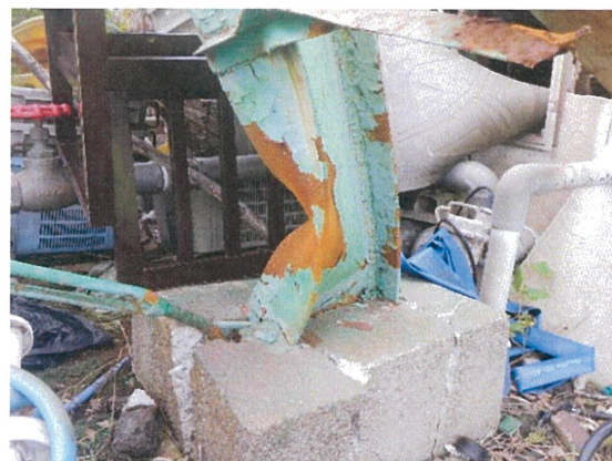
写真 3.5 鉄柱を構成するH形鋼の変形(1)
