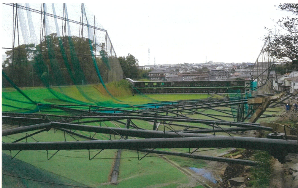
写真 3.15 鉄柱の倒壊状況(1)
